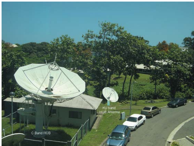
写真3. 敷地内設置の衛星通信アンテナ
