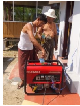
写真 12: 発電機で電気供給(2014.3.25)
